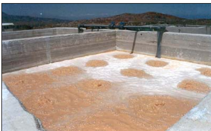
Φωτογραφία 1. Δεξαμενή Φωτοκαταλυτικής Οξειδωτικής επεξεργασίας στραγγισμάτων ΧΥΤΑ Δήμου Ρεθύμνου.
